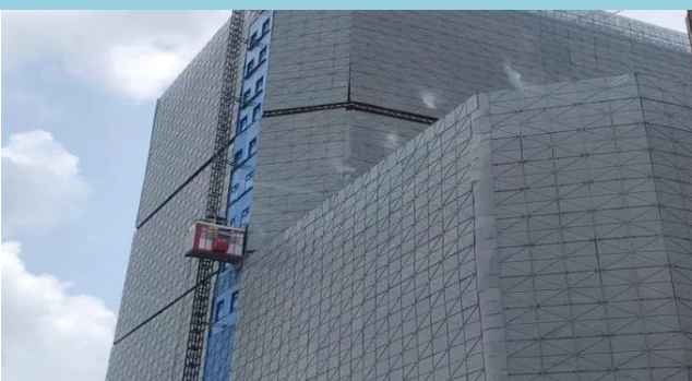
施工外脚手架喷淋系统
