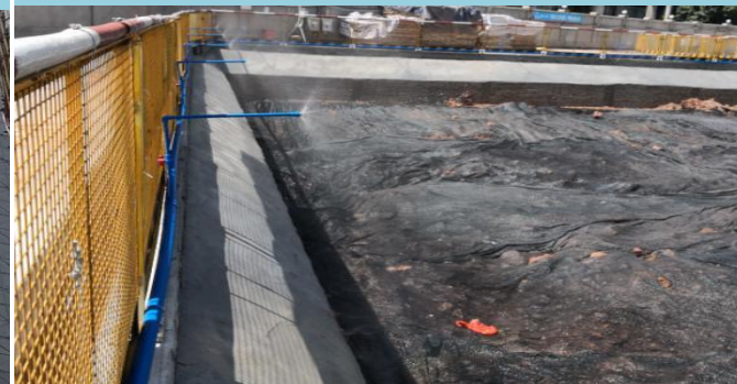
基坑喷淋系统
