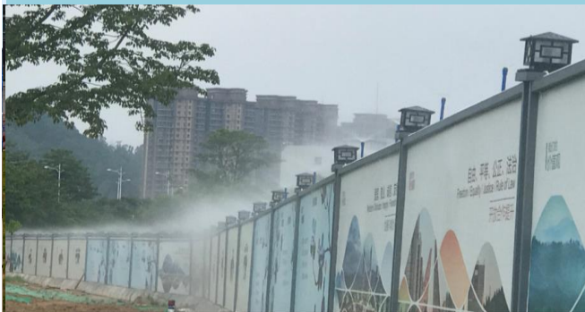
围墙喷淋系统
